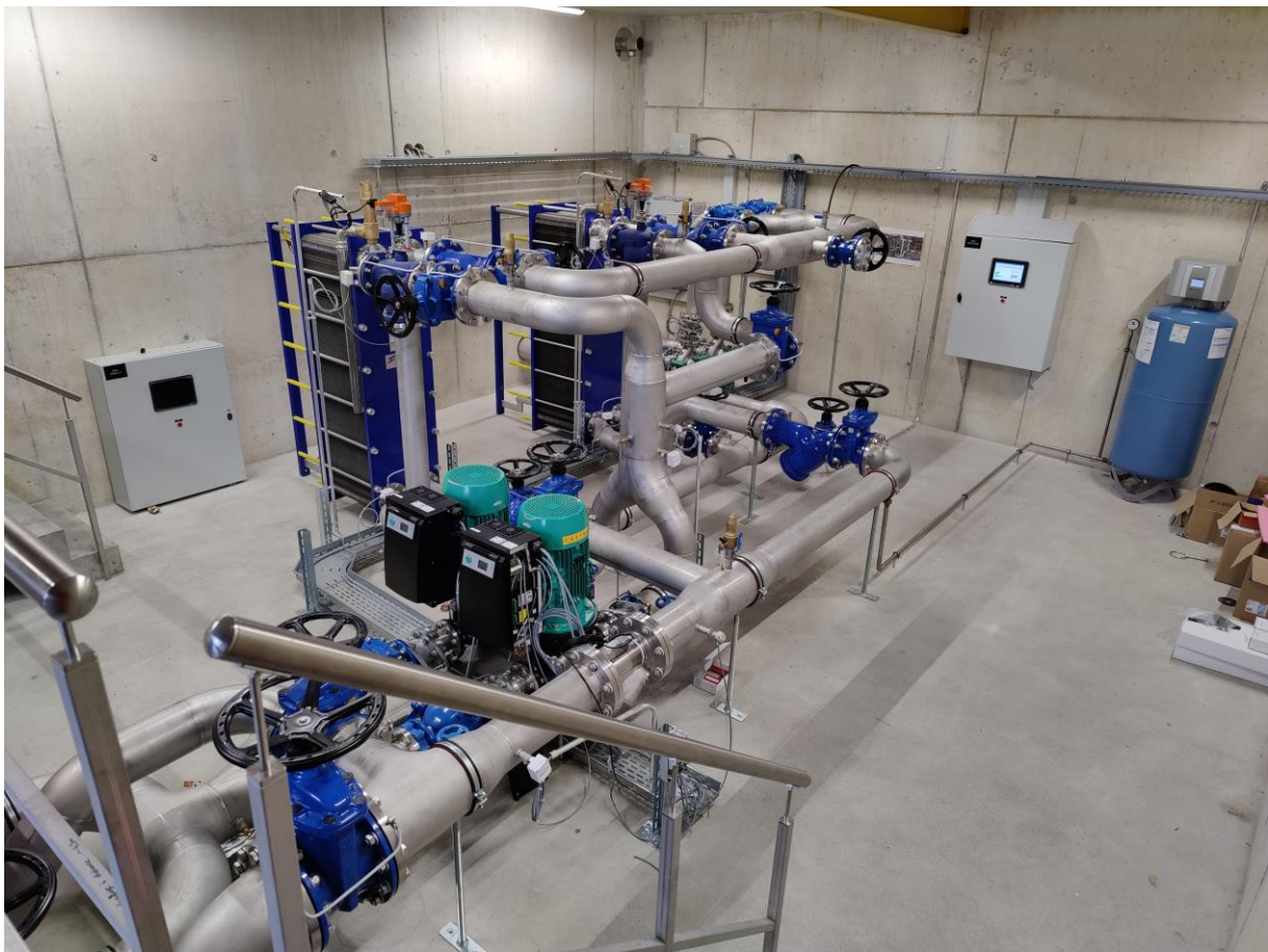
L'échangeur de chaleur du réservoir des Philosophes.
