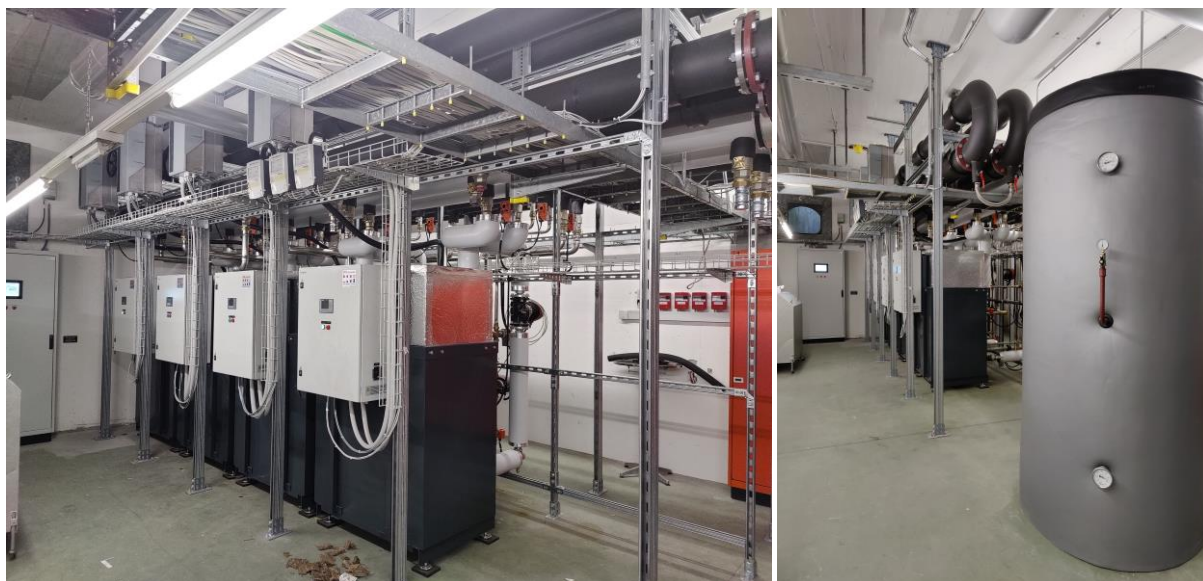
L'installation de chauffage à distance dans les sous-sols de l'Hôpital du Jura bernois.
